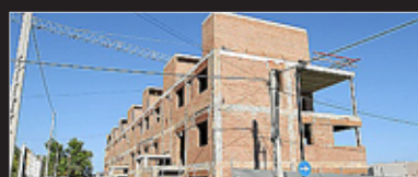
El edificio donde ocurrió el suceso.
