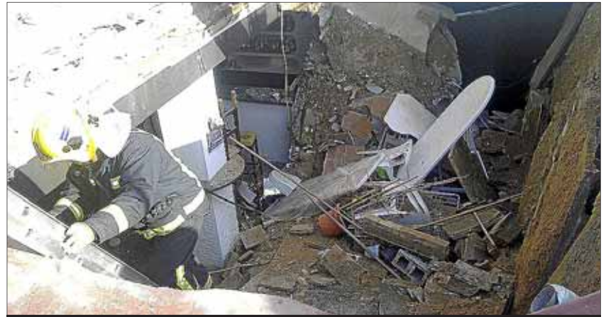
Uno de los bomberos accede al local por el boquete del tejado.
