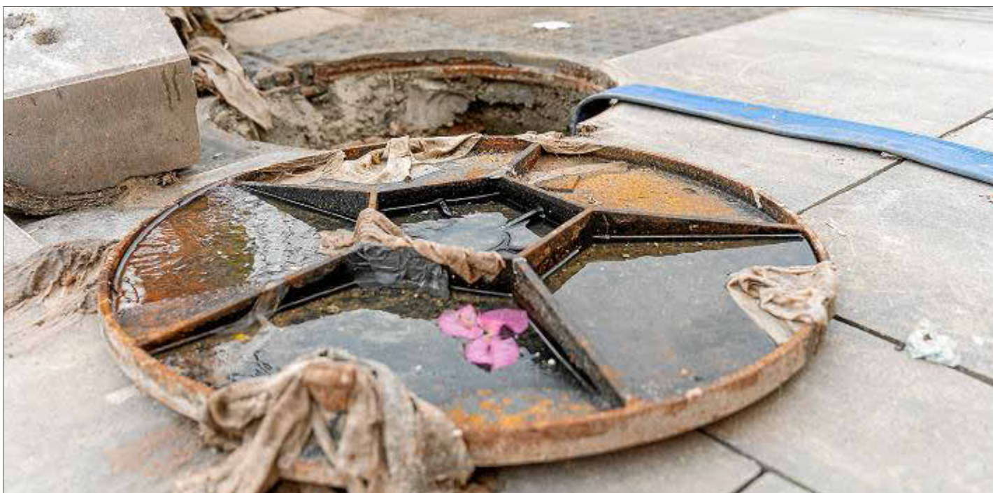
Muchas tapas de alcantarillas seguían ayer abiertas, 24 horas después de la lluvia. Foto: IRENE ARANGO
