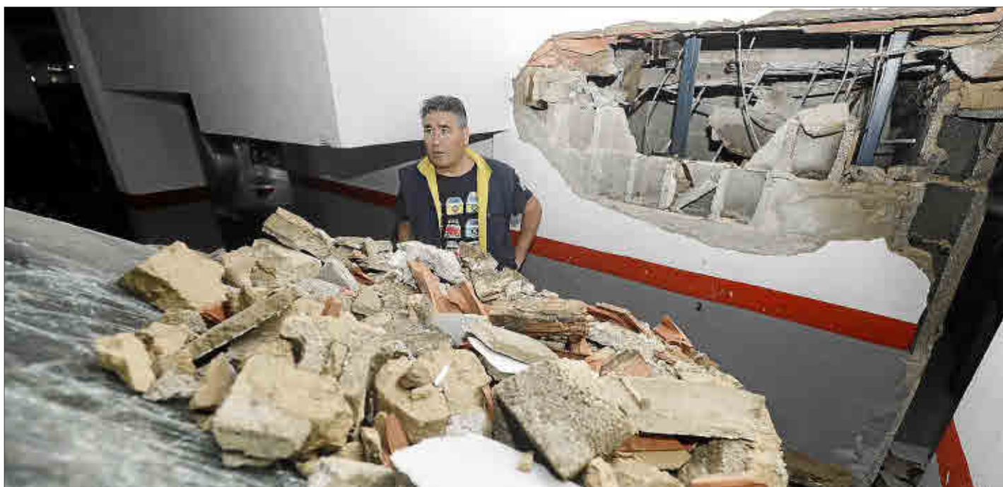
La cabina del ascensor provocó al caer un boquete en el garaje de la finca situada en la calle Obispo González Abarca. Foto: DANI ESPINOSA
