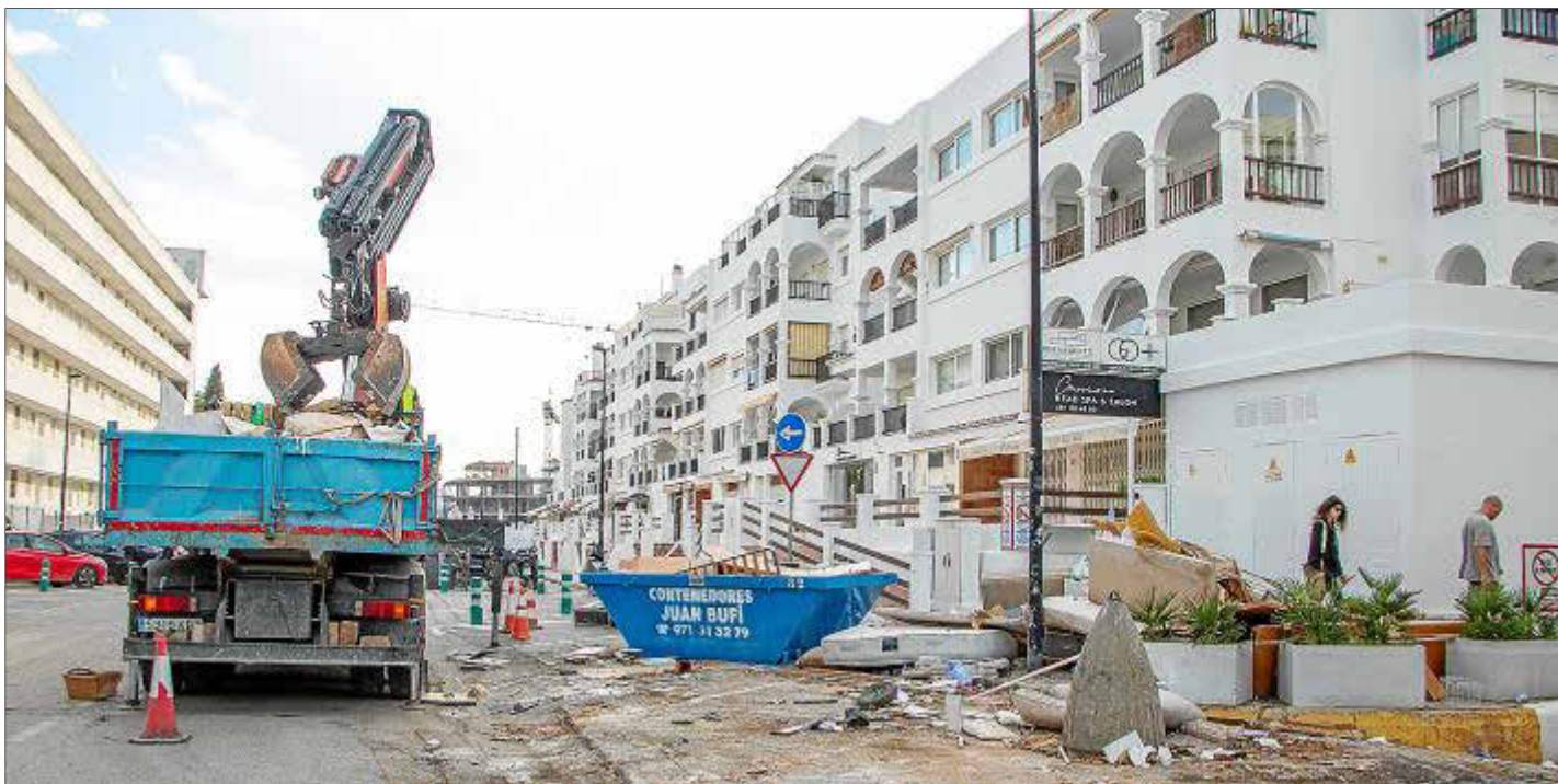
Las zonas del Brisol y polígono Eurocentro, cercanos a sa Llavanera, están aún muy afectadas. Foto: JÉSICA LÓPEZ
