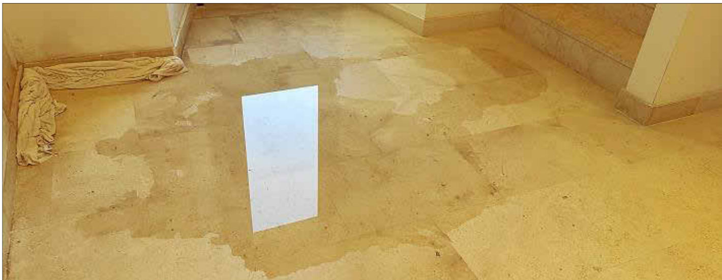
Charco de agua en el pasillo para acceder al baño del restaurante.
