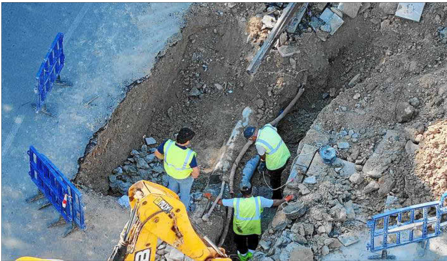
La intervención está resultando especialmente laboriosa debido a la ubicación de la tubería. Foto: CAIB
